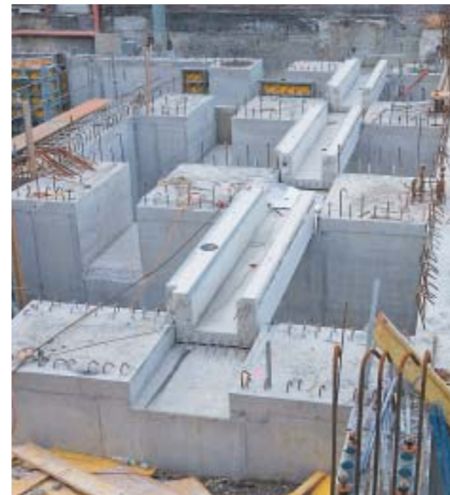
Bild 18. Pumpenzentrale Feinrechen und Siebbandkammern
