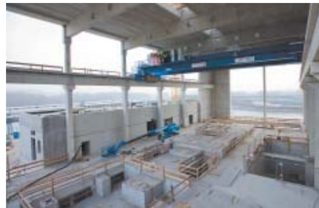
Bild 16: Maschinenhaus Turbinenflur +12m
