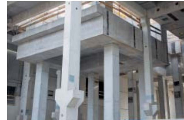
Bild 10: Maschinenhaus mit Turbinentisch
