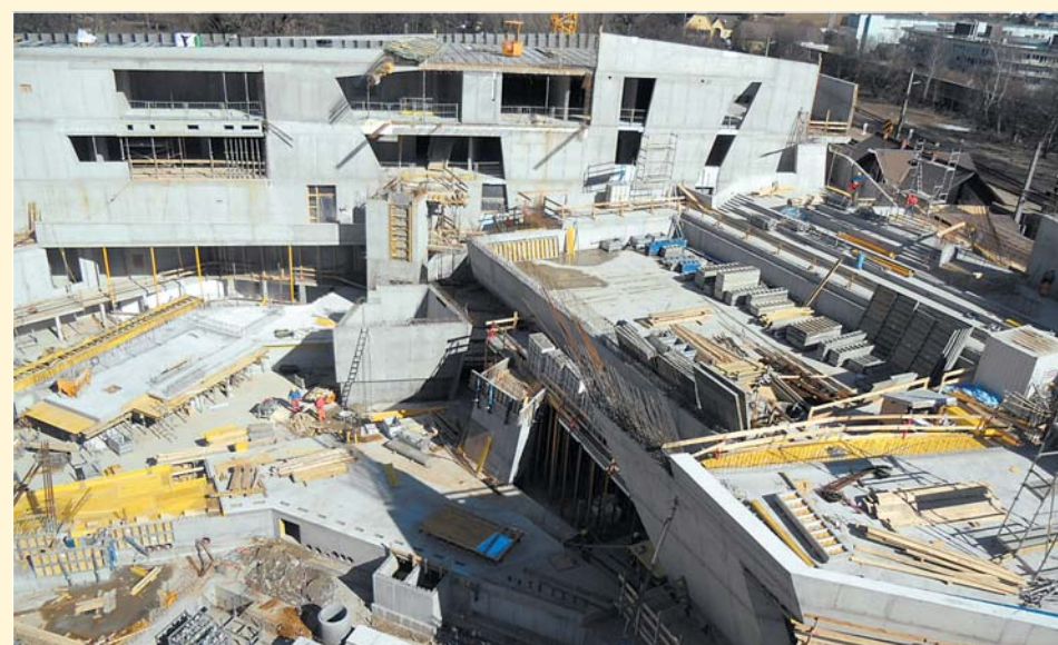
→ Ansicht von Süden Bauteil A im Hintergrund. Vorne rechts das Sportbecken im 2. OG
